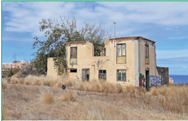
Die Casa Amarilla verkommt zur Ruine (Foto/SV)
